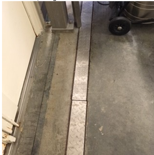
Afvoergoot was- en schrobwater, unit 2, dicht
