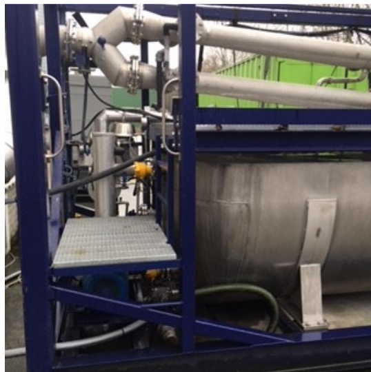
Aanvoer afgassen naar scrubber
